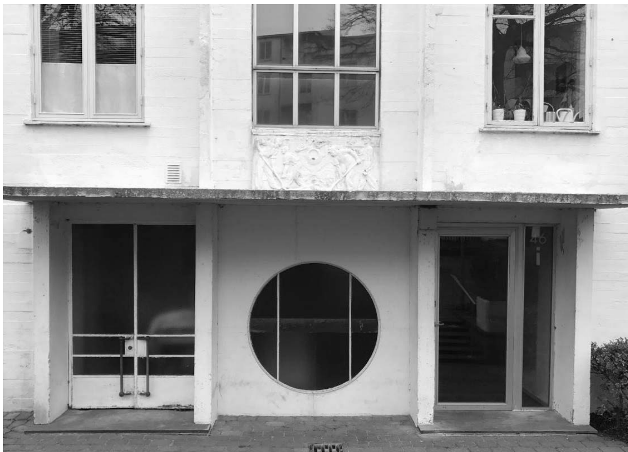
Den eneste bevarede adgangsdør er døren til teknikummet og det eneste uændrede store runde vindue findes i opgang I.
