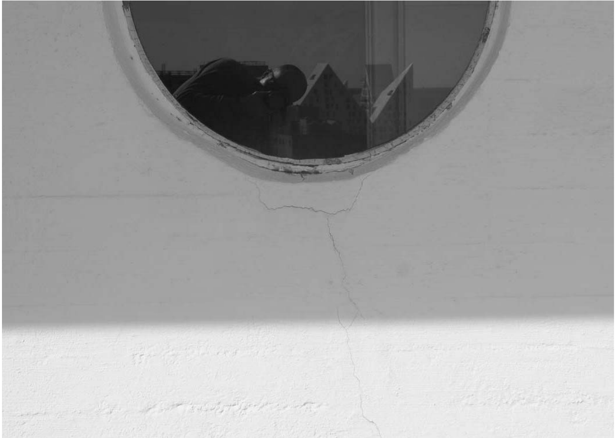
Revner ved jernvinduene skyldes tæring og delaminering i jernvinduene.
